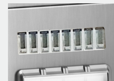
Abbildung 2 Sichtfenster auf hinterleuchtete Stromzähler und Eichmarke
